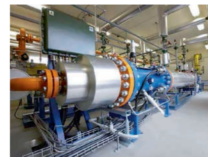
ФОТО 5. Газорасширительная турбина — основа инновационной электростанции
