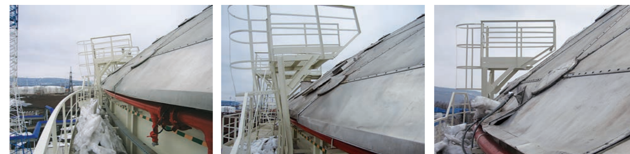
РИС. 5. Последствия схода подтаявшего снега
