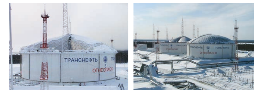
РИС. 4. Разрушение конструкции алюминиевой крыши п. Талакан
