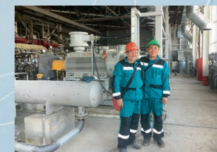
Сервис на площадке Сибур
