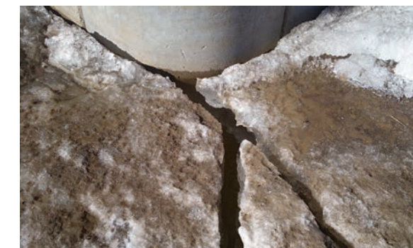
РИС. 8. Разрушение льда возле опоры моста
