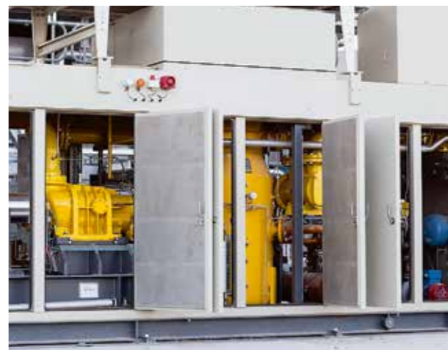
ФОТО 4. Оборудование газоподготовки для испытательных стендов «Невского завода»
