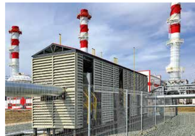
ФОТО 1. Энергоцентр Усинского месторождения. БППГ «ЭНЕРГАЗ» в эксплуатации
