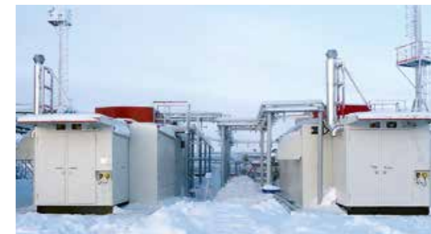
ФОТО 3. КУ низкого давления в составе СКНС Северо-Лабатьюганского месторождения
