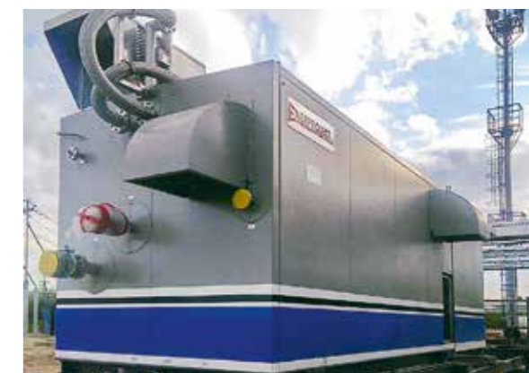
ФОТО 8. Вакуумная КС в составе УПСВ-4 Вахского месторождения
