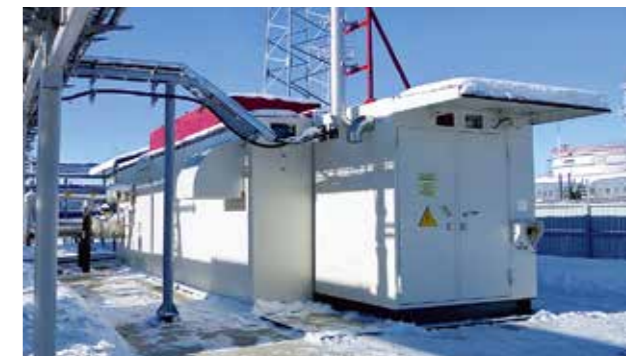
ФОТО 2. Установка для компримирования низконапорного попутного газа
