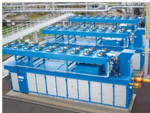
ФОТО 5. Дожимная компрессорная станция для ГТУ Центральной ТЭЦ Санкт-Петербурга
