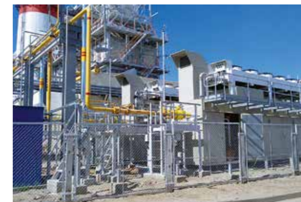
ФОТО 9. Пункт подготовки газа обеспечит топливом ПГУ Могилевской ТЭЦ-1
