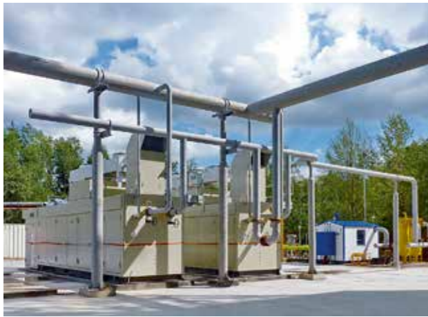
ФОТО 10. Многофункциональная СПГ для центра энергоснабжения ОАО «Ангстрем-Т»
