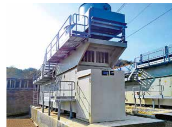
ФОТО 7. Система газоподготовки «ЭНЕРГАЗ» установлена на площадке ТЭЦ «Восточная»
