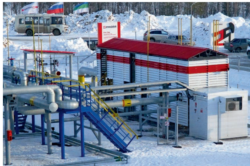
ФОТО 4. Блок подготовки попутного газа для ГТУ-ТЭС Усинского месторождения ЛУКОЙЛ-Коми
