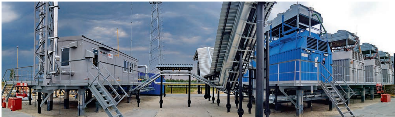
ФОТО 6. УПТГ «ЭНЕРГАЗ» (слева) в составе газопоршневой электростанции Барсуковского месторождения Роснефти
