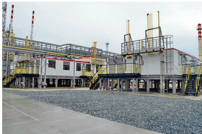
ФОТО 2. Установка подготовки топливного газа для объектов УКПГК на Восточном Уренгое – основной (слева) и резервный модули
