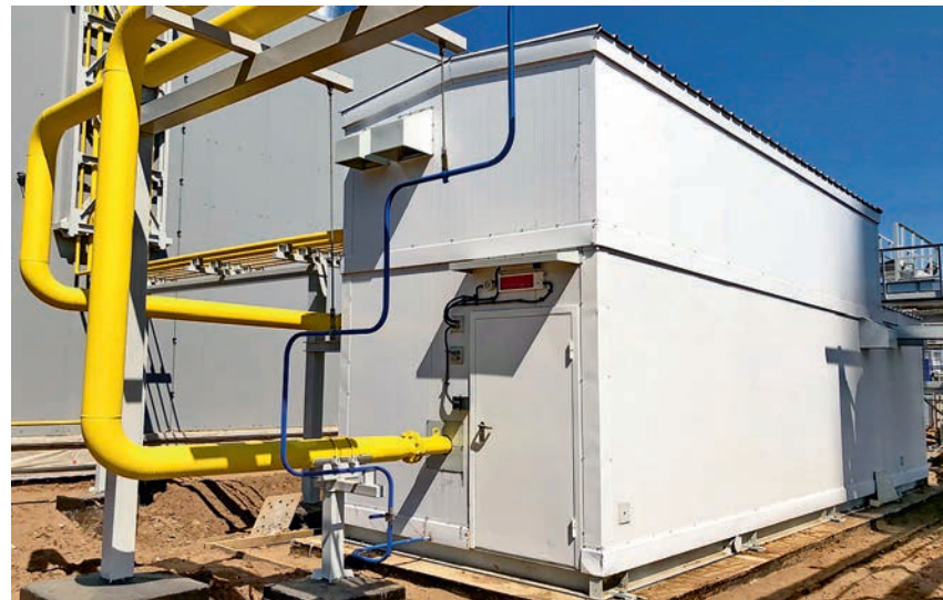
ФОТО 5. Блочный пункт очистки газа для ГТУ-ТЭС в Елабуге – компактная установка в базовой комплектации
