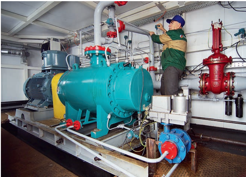
РИС. 3. Размещение оборудования в насосном модуле МНС-240
