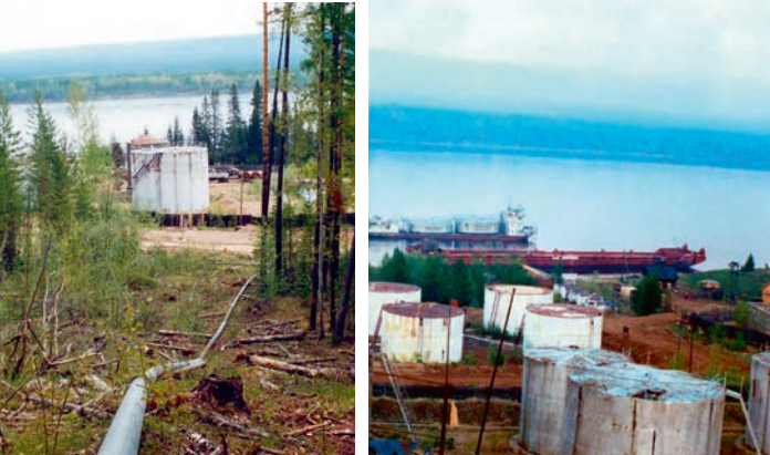
РИСУНОК 4. Сборно-разборный трубопровод ПМТП-150 на конечном пункте нефтепровода «Талаканское ГНМ – Витим»
