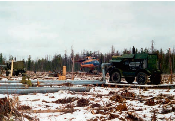
РИСУНОК 8. Насосная станция на трассе нефтепровода «Талаканское ГНМ – Витим»
