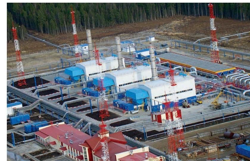
ГПА серии «Урал» на компрессорной станции
