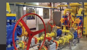
Блочные пункты подготовки газа
