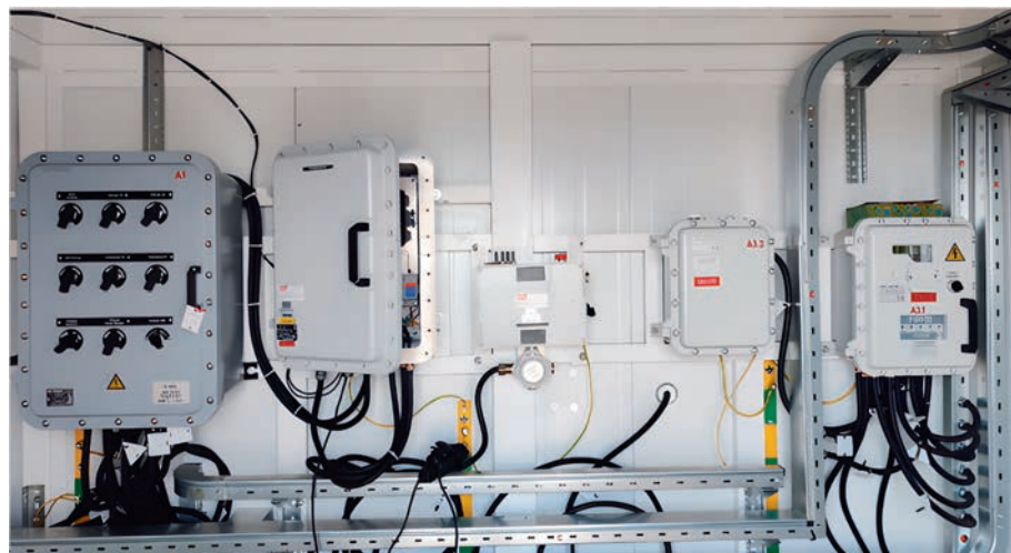
Помещение локальной системы управления
