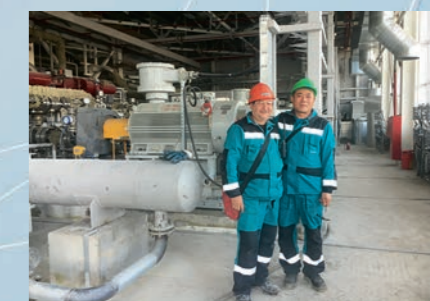
Сервис на площадке Сибур
