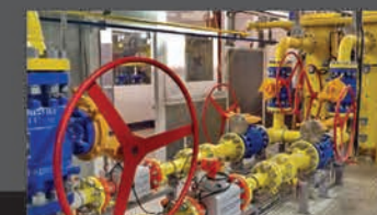
Блочные пункты подготовки газа
