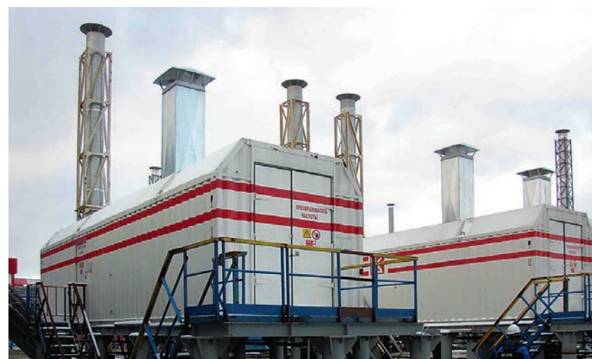
Высоковольтный преобразователь частоты в блок-модуле на Баяндыском месторождении. Республика Коми
