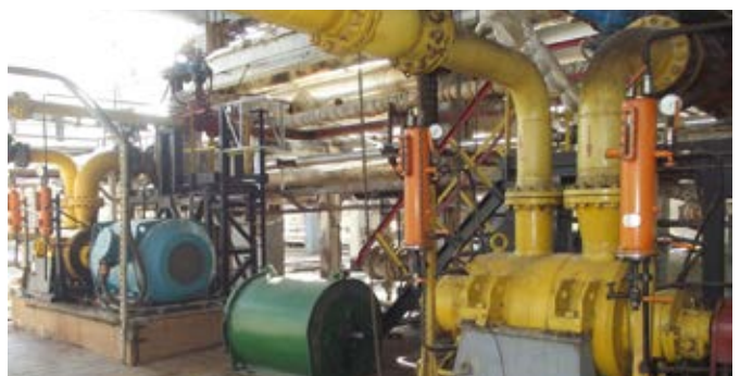
Рис. 4 После реконструкции установки «Дуосол-22»
